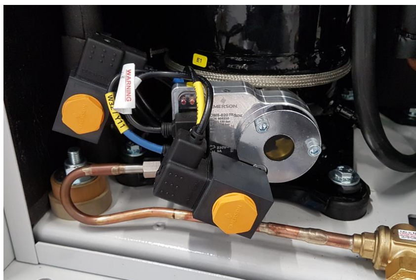
Figure 39 : TraxOil OM5 monté sur le compresseur
