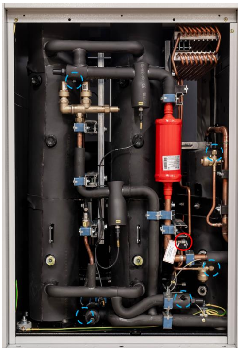
Figure 45 : Raccords de service pour les groupes bi-compresseurs
