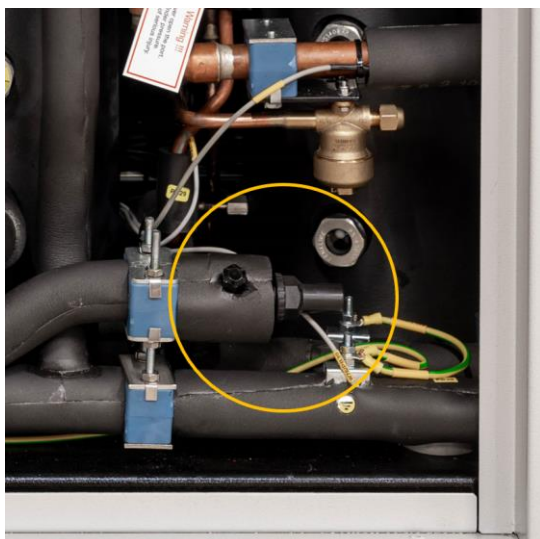
Figure 52 : Gros plan sur la vanne d'arrêt à l'arrière de la bouteille réservoir sur groupes bi-compresseurs
