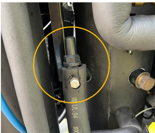
Figure 49 : Gros plan de la vanne d'arrêt à l'arrière de la bouteille réservoir sur groupes OME-16T
